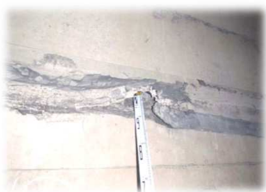
壁面打継部の剥離
