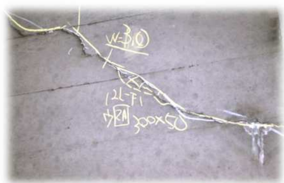
覆工アーチ部のひび割れ
