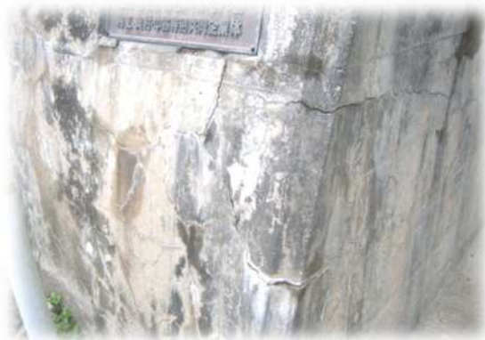
抗門面壁のひび割れ
