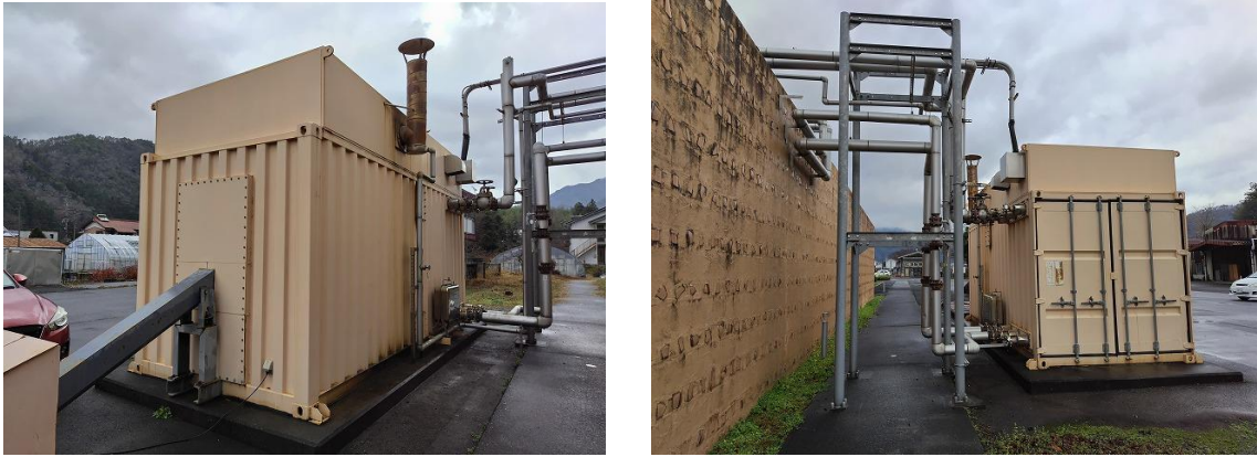
図 2-4 木質バイオマスボイラ（むいかいち温泉ゆ・ら・ら）
