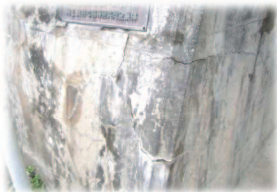
抗門面壁のひび割れ
