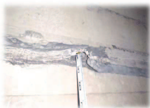
壁面打継部の剥離
