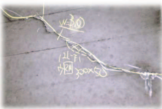
覆工アーチ部のひび割れ
